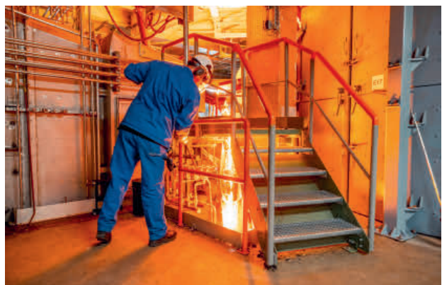
Der Elektroschmelzofen besteht aus Stahl und ist wasser- und luftgekühlt.
